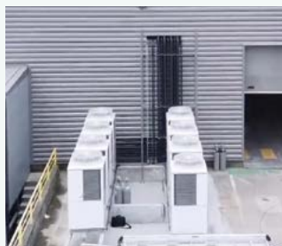
STEMCELL Technologies, ett globalt bioteknikföretag, installerade CR-seriens kondensorenhet med koldioxid för kylrummen i sitt lager. Frankrike. Kylteknik
